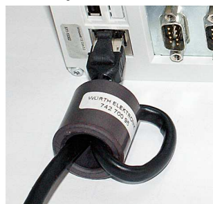
Abb. 40 Ethernetkabel, Schlaufe 2-fach durch Ferrit
