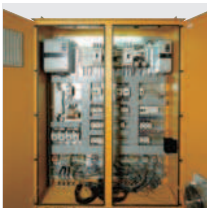
Bild 4: Beispiel für eine Schaltanlage für die Automatisierung von Maschinen und Anlagen, mit anteiligem Leistungs- und Steuerungsteil.
