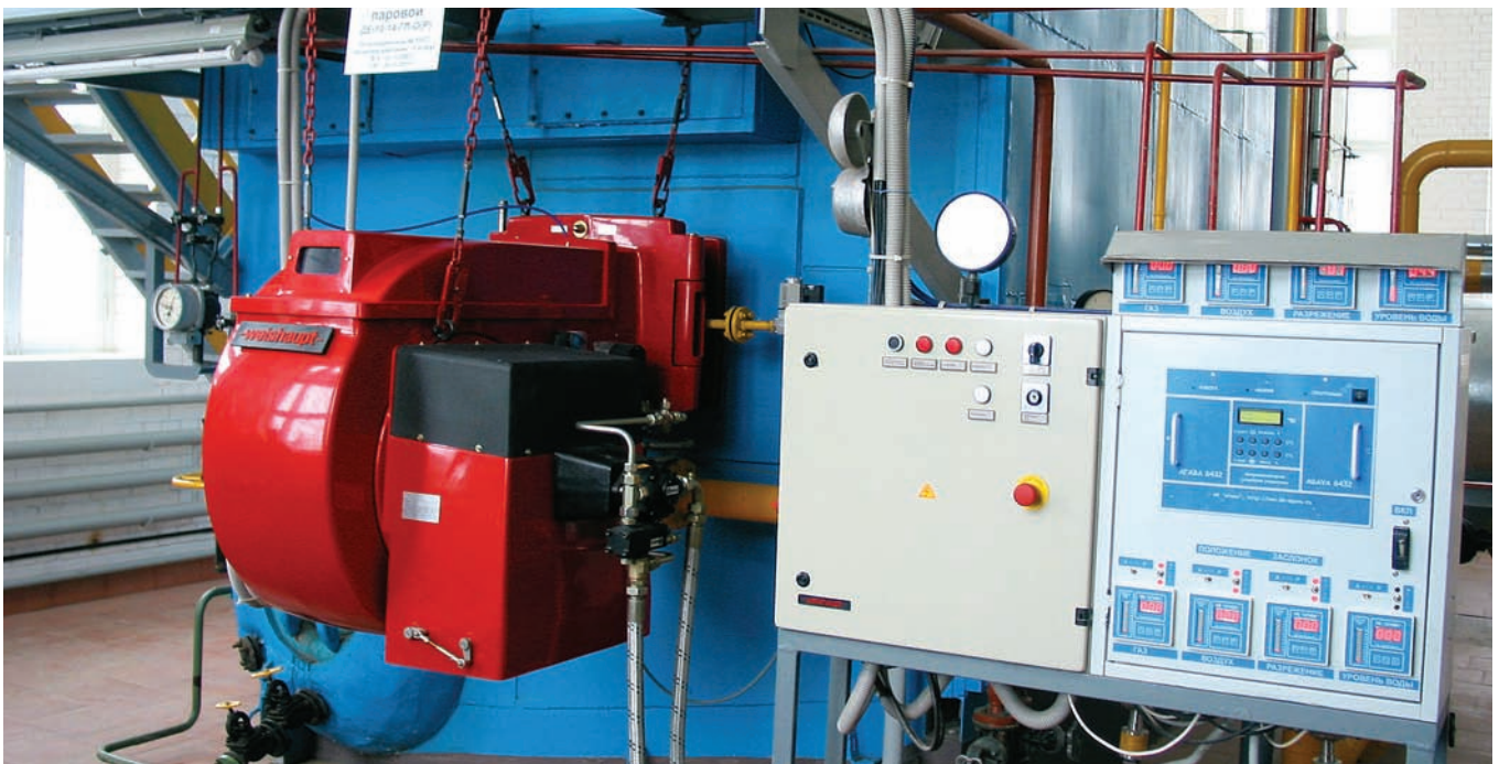
Котел ДЕ-10 с комбинированной горелкой RGL70 исполнения SF
