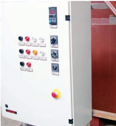
Шкаф управления Weishaupt
