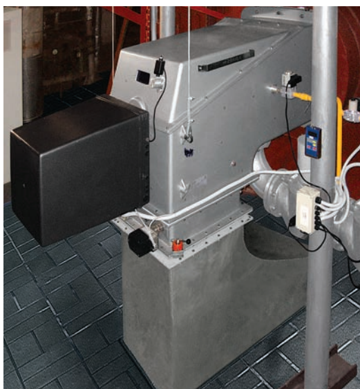
Газовая горелка WKG 80 на котле DE-25
