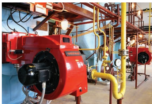
Котлы ДЕ-25 с комбинированными горелками RGL60
