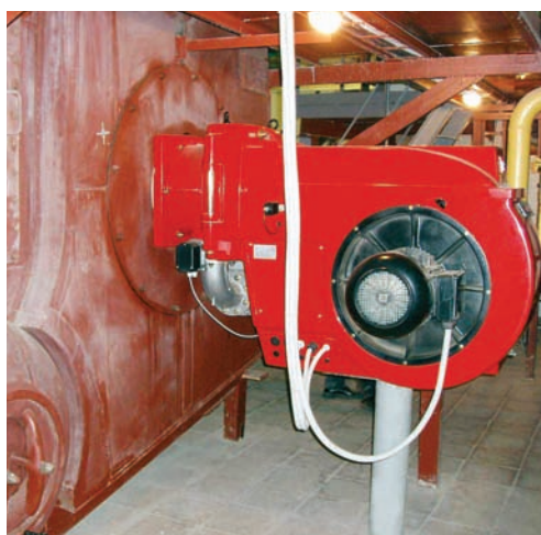
г. Кемерово. Котел ДЕ-10 с газовой горелкой G70 исп. SF
