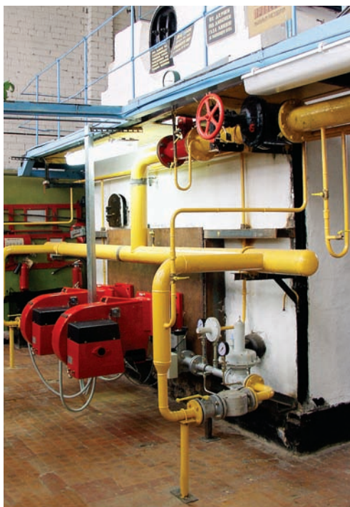
Модернизированный котел ДКВр-6,5 с горелками G40
