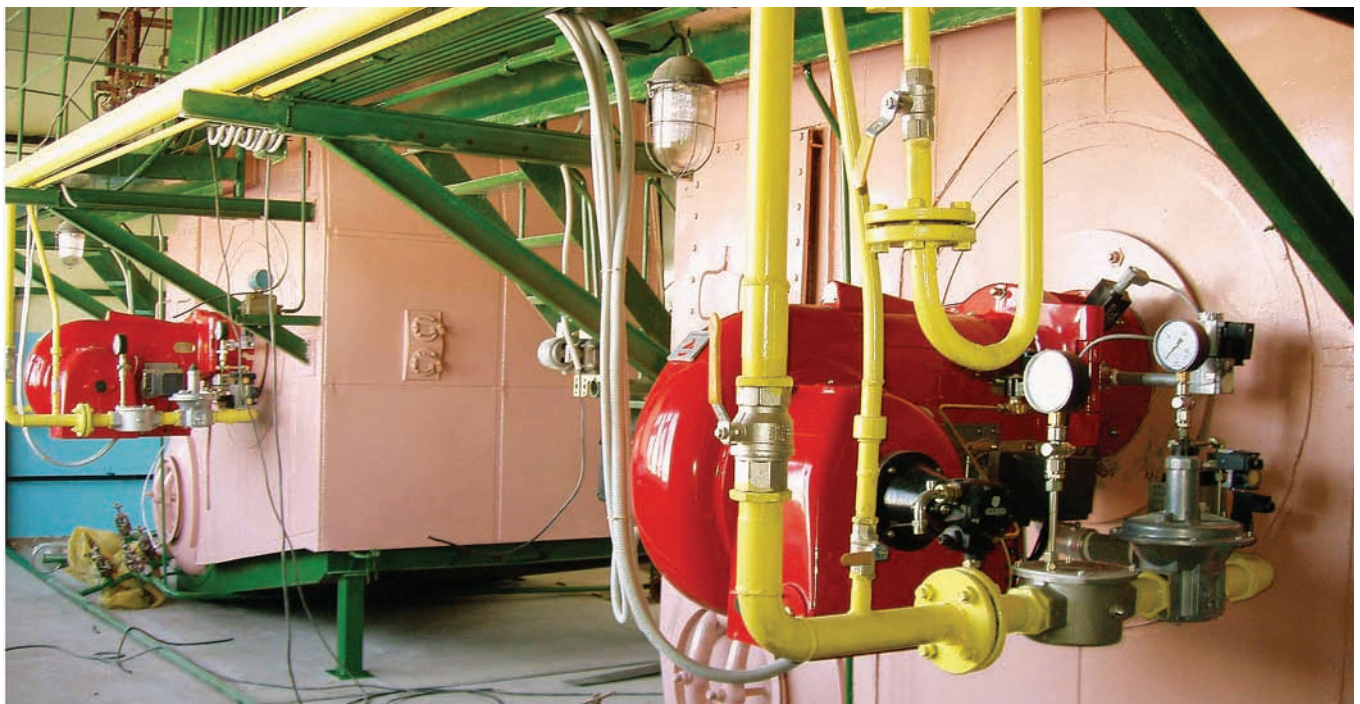
Котельная ООО «Полиформ бетон»
