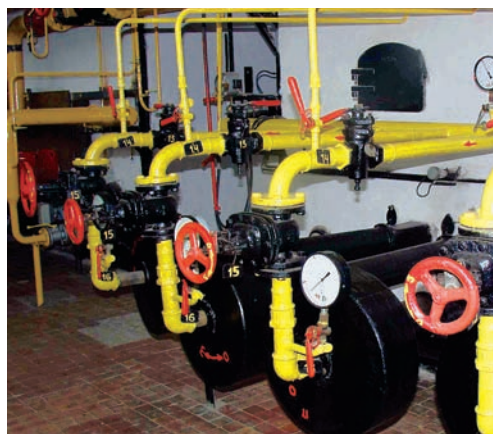
Котел ДКВр-6,5 с горелками ИПГ-250 КПД котлоагрегата 91,02% NOx – 366 мг/м3 (на газе, 100% нагрузка, \alpha = 1 )
