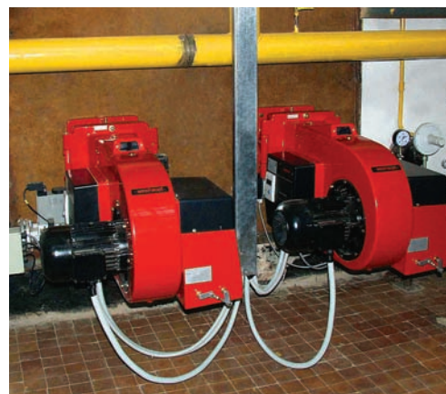
Котел ДКВр-6,5 с горелками Weishaupt КПД котлоагрегата 94,5% NOx – 71,3 мг/м3 (на газе, 100% нагрузка, \alpha = 1 )
