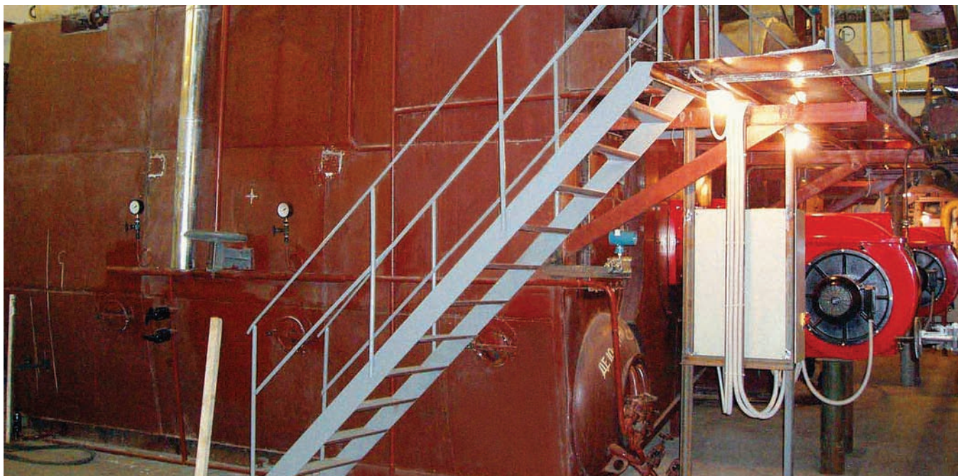
Котельная с котлами ДЕ-10 и газовыми горелками G70 исполнения SF с микропроцессорным менеджером горения
