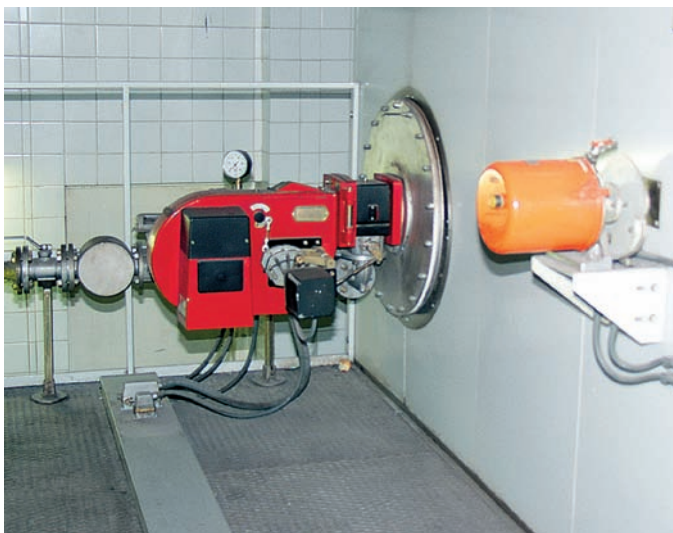
Газовая горелка G 3 на хлебопекарной печи
