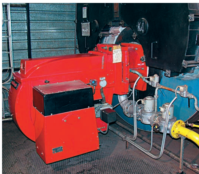
Горелка G 70 на жаротрубном паровом котле
