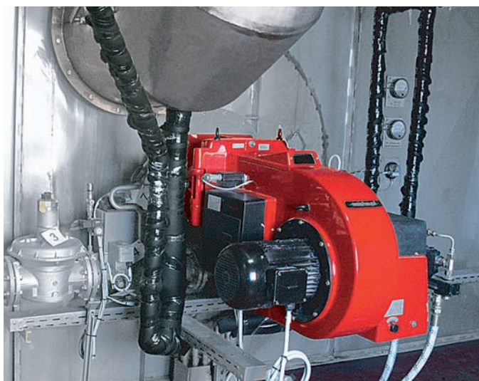
Горелка RGL 50 на воздухоподогревателе
