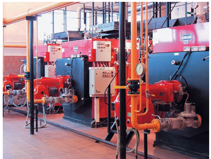
Паровая котельная фабрики «Каприз»
