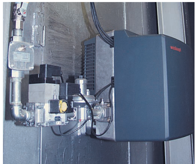
Горелка Weishaupt на печи нагрева воздуха
