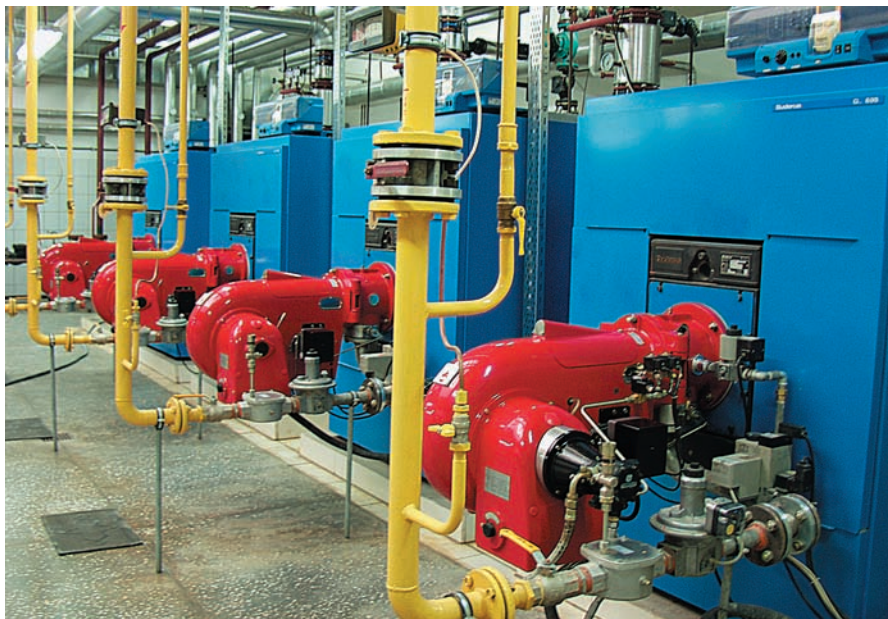
Подземная котельная культурного центра
