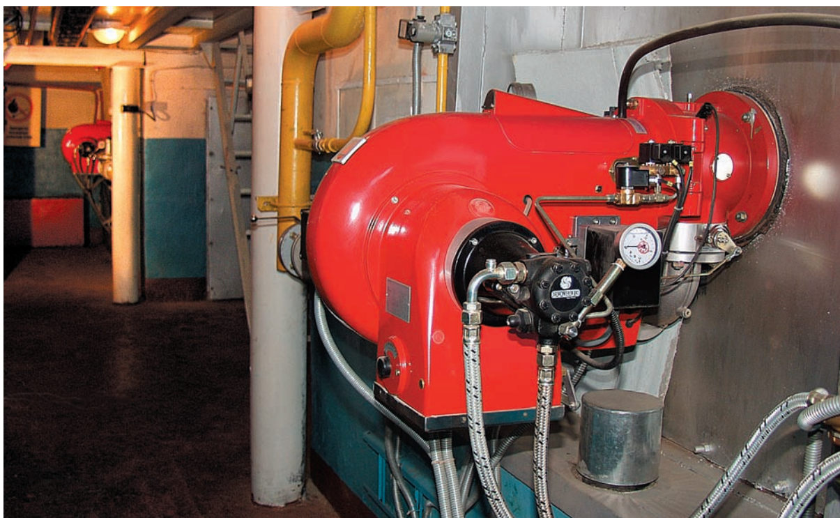
Две горелки GL 8 на зерносушильных камерах
