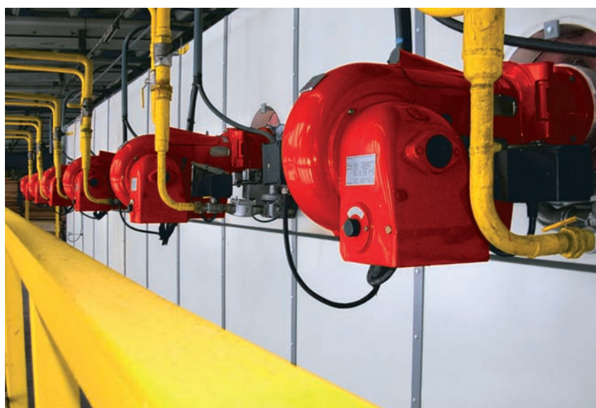
Горелки Weishaupt на теплогенераторах горячего воздуха
